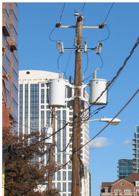
Фото. Городские линии электропередачи в центре г. Атланта, США
