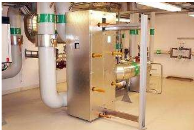
Рис. 2. Центральный тепловой пункт (ЦТП), фото с сайта www.sao.mos.ru
