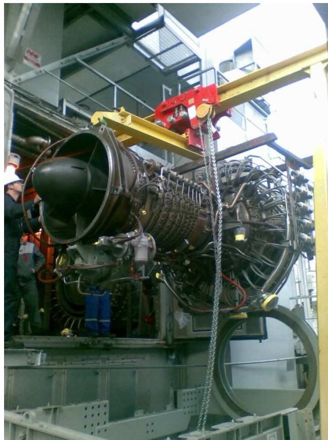
Рис. 2. Газотурбинный энергоблок ГТУ-ТЭЦ «Луч», г.Белгород, фото с сайта www.tgk-4.ru
