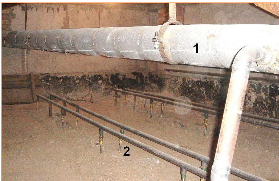
Рис. 3. Установленные в техническом подполье жилого дома теплообменники: 1 – сточно-гликолевый теплообменник, 2 – грунтовый теплообменник.
