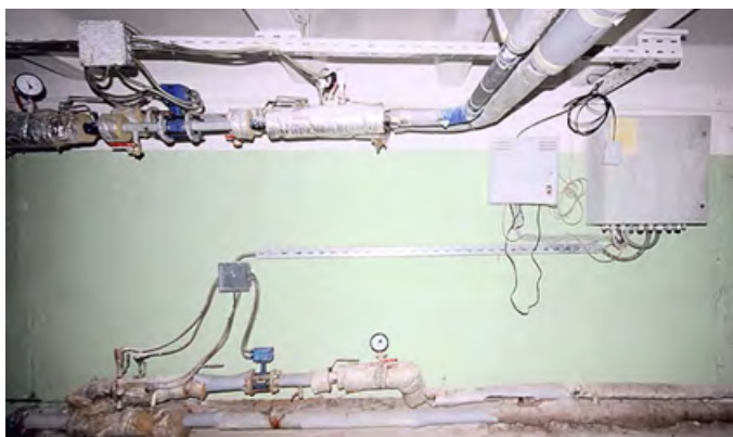
■ Прибор учета тепла и трубы отопления в подвале. Трубы на полу требуют восстановления теплоизоляции
