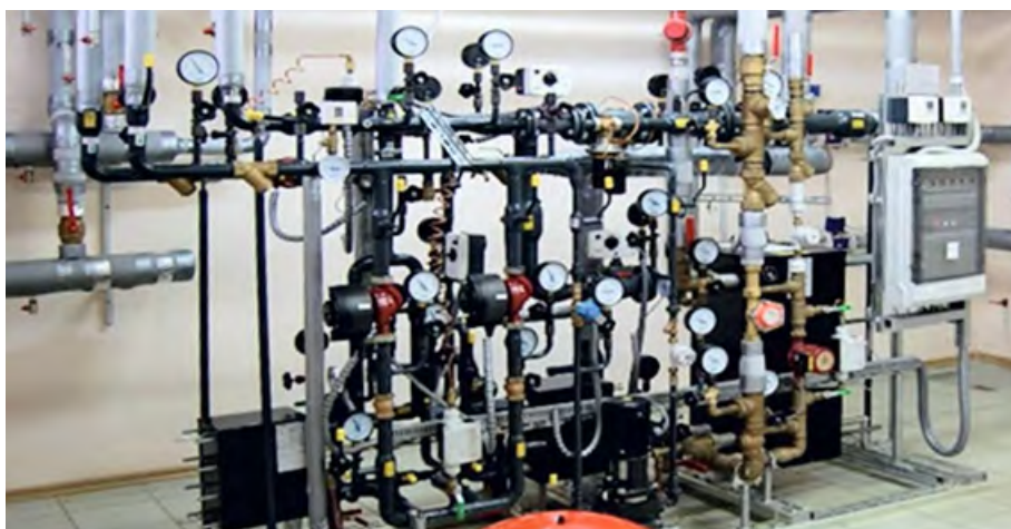
■ Фото 2. Сборный автоматизированный тепловой пункт
