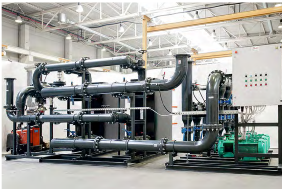
■ Фото 1. Автоматизированный тепловой пункт заводской сборки
