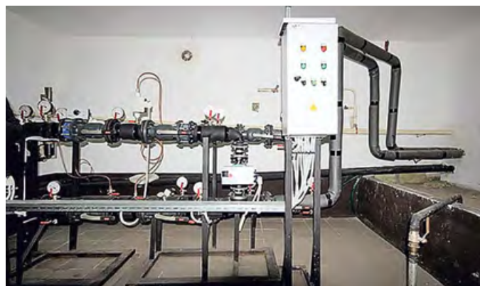
■ Образцовый автоматизированный узел управления теплом и отличное состояние подвального помещения
