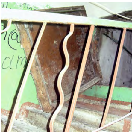
■ Безобразное состояние двери входа на чердак и кровлю
