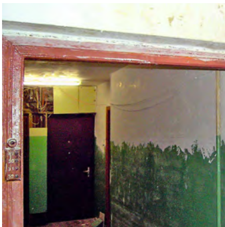
■ Опасное состояние распределительной щитки и проводки
