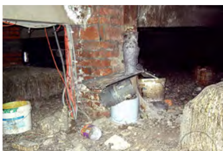
■ Отвратительное состояние чердака и дырявое колено внутреннего водостока
